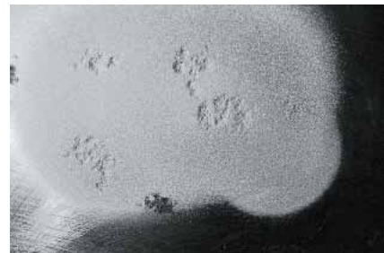
Ein Rostnest muss noch gestrahlt werden, dann ist die behandelte Stelle fertig.
